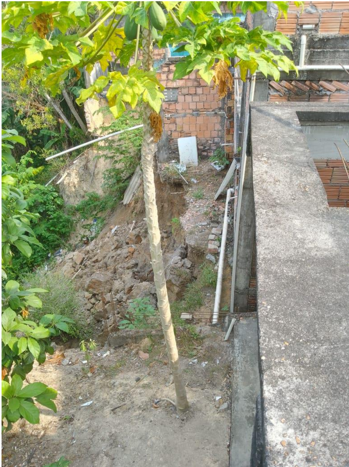
Vista dos imóveis em situação de risco.
