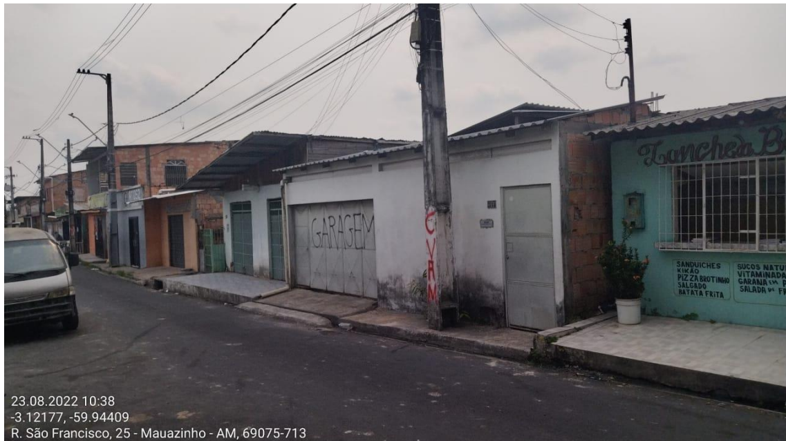
Vista dos imóveis em situação de risco.
