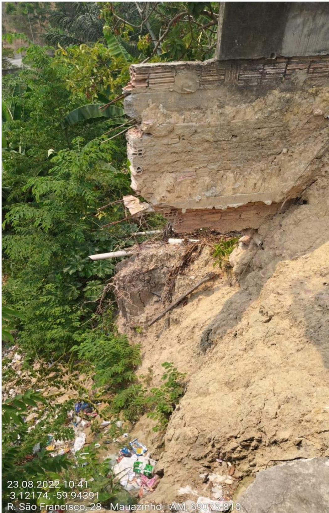
Vista do desabamento parcial da área dos fundos do imóvel do Sr. Sebastião.
