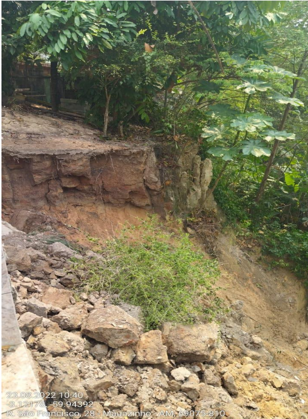
Vista da crista da encosta que está em processo erosivo ativo.
